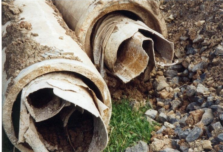
Foto Nr. 1 - eingedrückter Inliner, Wandstärke 6 mm, in Betonrohren
